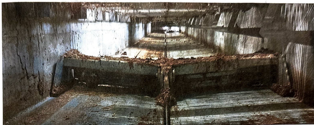
Der Kanalboden mit Harnsammelrinne in einem Schweinestall hilft, die Ammoniakemissionen zu reduzieren. (Bild: Markus Bucheli, BBZN)
